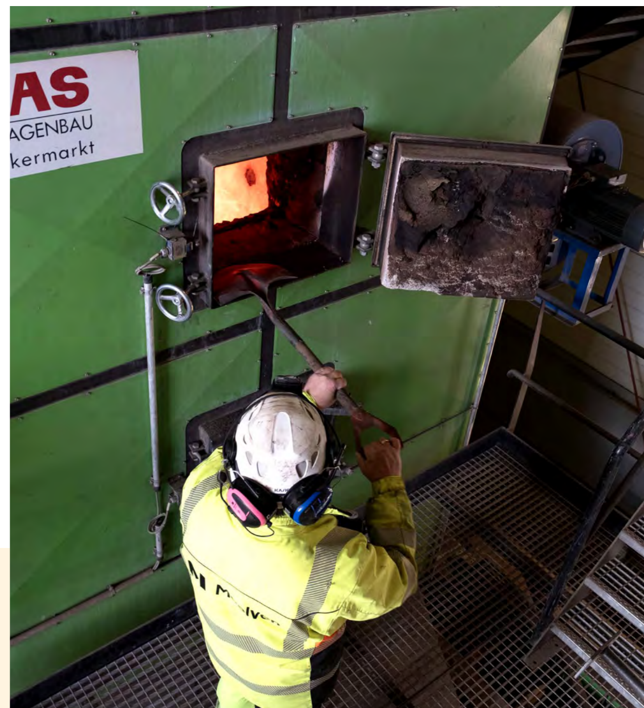
Visuell kontroll av forbreningen. Temperaturen inne i forbrenningskammeret kan komme opp mot 1000 grader C.
